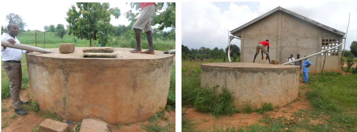
Système de rétention d'eau de pluie mis en place par l'ONG CREDO dans une école à Abosehoe (Photo par Dr. Dodzi)
